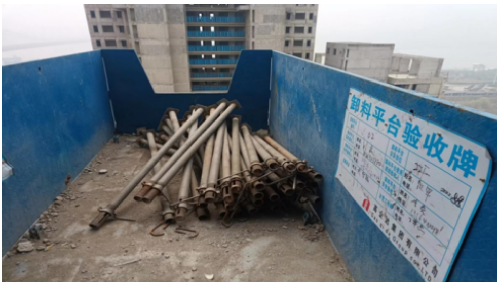
图3 卸料平台及事故吊运的单支顶
