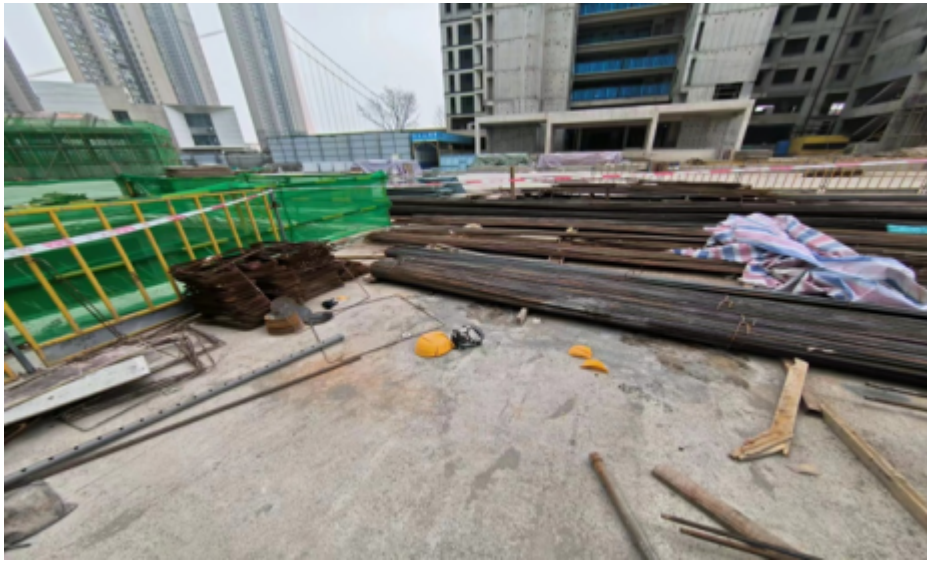
图2 钢筋加工场露天成品堆放区内散落的插管及安全帽
